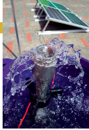
Solarenergie sichert die Wasserversorgung im Projekt.
